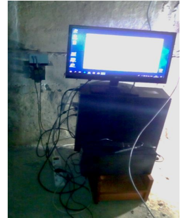
Нахиломірна станція Nivel 210 встановлена в готелі «Візит»
